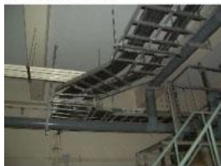
ケーブルラック配線
