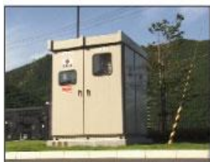
高圧受電設備 キュービクル
