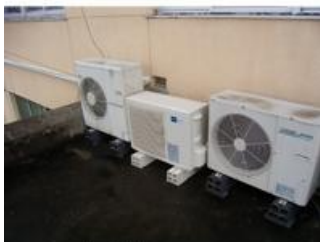
エアコン室外機
