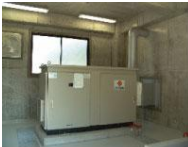
非常電源設備（発電機）
